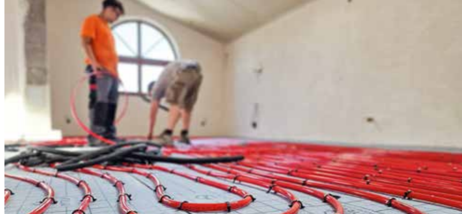
Heizkomfort für alle: Unsere Experten installieren eine moderne Fußbodenheizung – für warme Räume und zufriedene Kund:innen.
